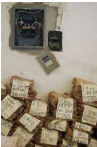
Ejemplo de peligro por instalación eléctrica
