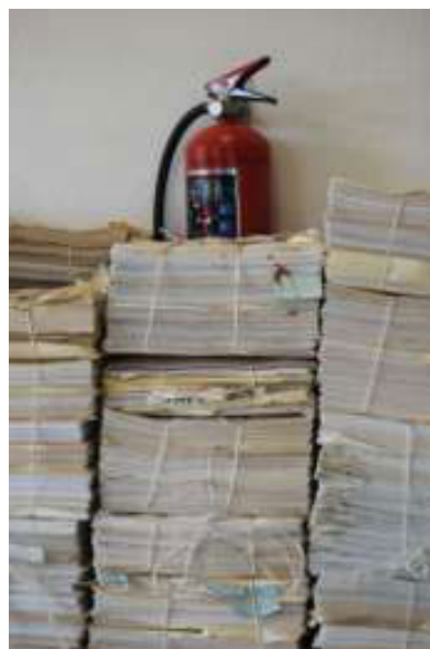
Ejemplo de extintor bloqueado
